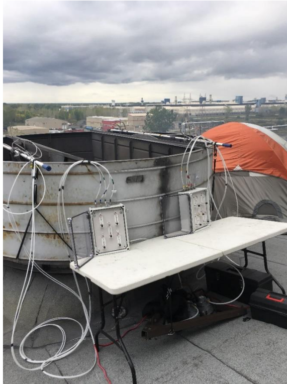
Photo 1 : Exemple de dispositifs d'échantillonnage pour ventilateur de toit
